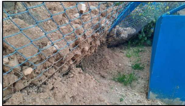
Deslizamiento en el distrito de Jangas
