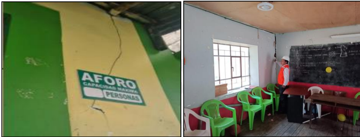
Aula afectada de la IEP Kana del distrito de Ayapata
