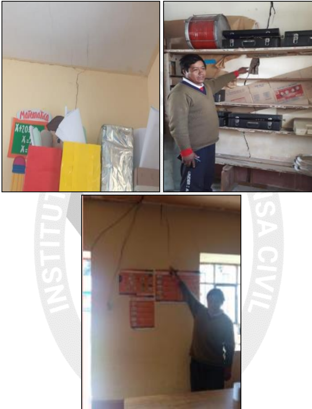
Local Educativo N° 72169, con aula afectada.
