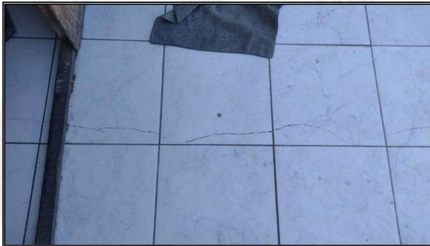
Daños materiales (rajadura de techo y piso) en la Comisaria PNP “JUAN DE DIOS COLCA APAZA”
