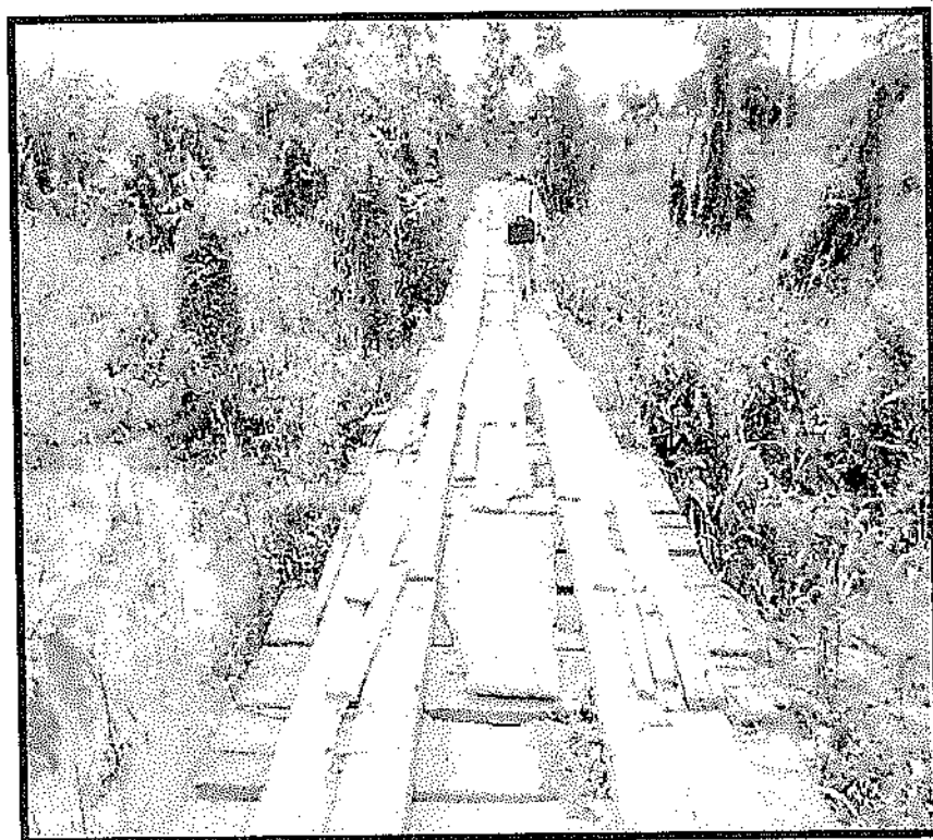
FOTO 6: PUENTE EN PESIMAS CONDICIONES PARA LA POBLACION DEL C.P SAN PABLO.
