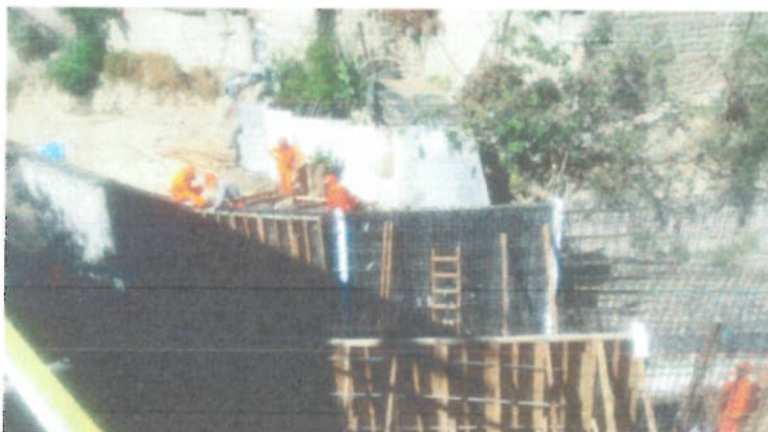
IMAGEN N° 03: Afianzamiento de la Parte Estructural de la Sección Rectangular, para llevar un adecuado Control del metrado diario en campo de todo el proceso constructivo de la obra del 0+400 al 1+200.
