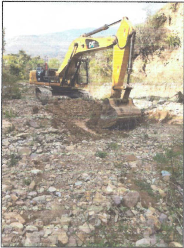
Fotografía N° 2: Inicio de los trabajos de descolmatación con Excavadora sobre oruga de 115-165 HP.
