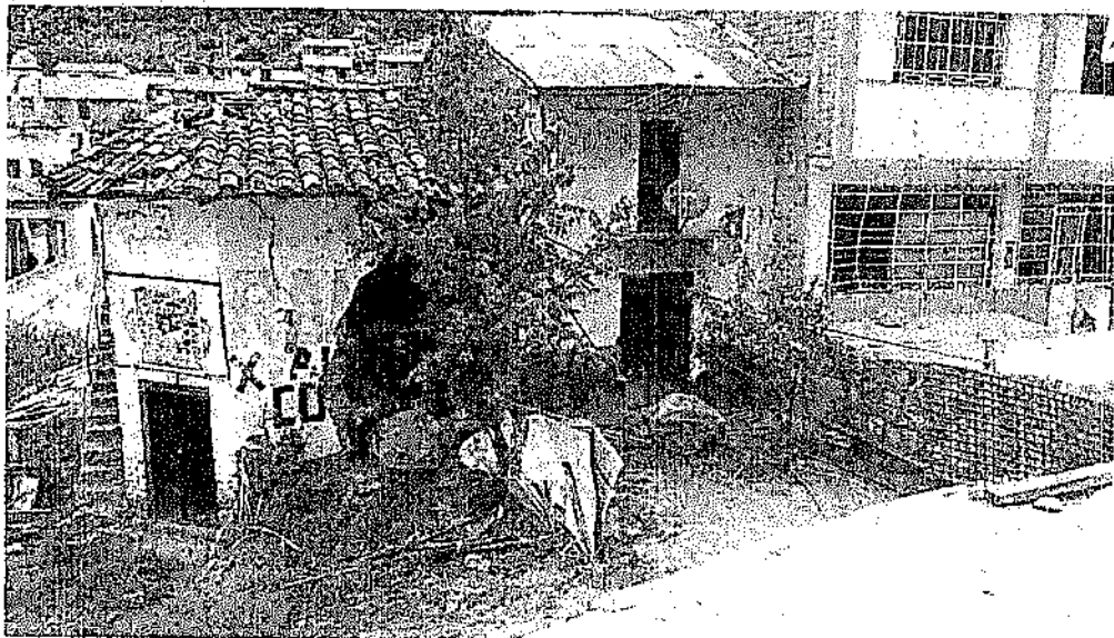
Vivienda destruida del Sr. Marmarillo, una de las 15 familias afectadas por el desprendimiento de rocas.
